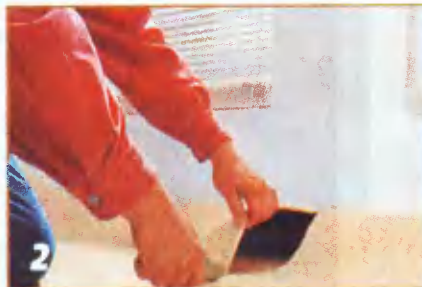
2 У стены, углом выступающей в комнату, покрытие надрезают, чтобы аккуратно уложить его около этого выступа.
